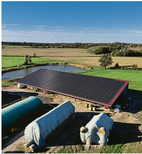
Terre et Lac développe déjà plus de 70 projets sur des toitures et des ombrières de parking dans la moitié sud du pays.
